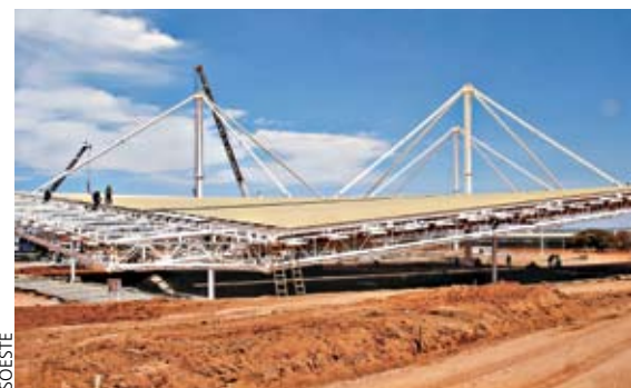
A obra da rodoviária de Brasília será constituída de estruturas V&M e telhas ISOESTE
