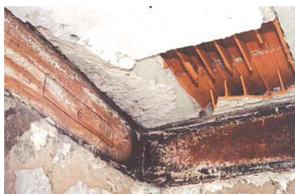
Figura 4 - Detalhe das lajotas cerâmicas danificadas
