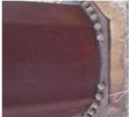
Poste de distribuição elétrica em aço oxidado
