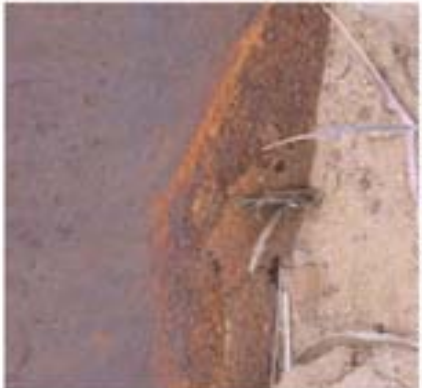
Quantidade significativa de produtos de corrosão
