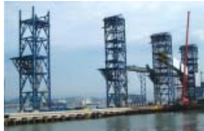
Torres de sustentação dos equipamentos para carregamento de navios do Terminal de Granéis do Guarujá – TGG
