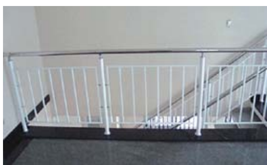
Figura 5: Eletrólitos são, de modo geral, ausentes em ambientes internos aerados e aquecidos. A combinação de ligas metálicas tais como aços inoxidáveis e aços carbono (pintado ou não) não envolvem riscos do aparecimento da corrosão galvânica.
