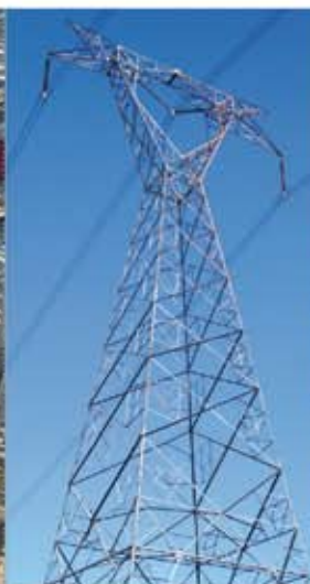
SIEMENS Rio de Janeiro - 1.500 toneladas
